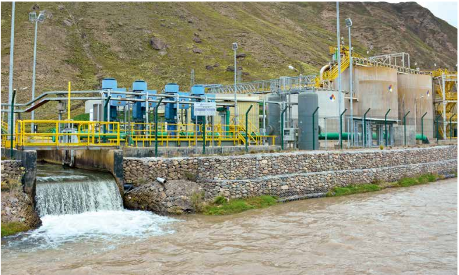
Actual Planta de Tratamiento de Aguas del Túnel Kingsmill 金斯米尔水处理厂
